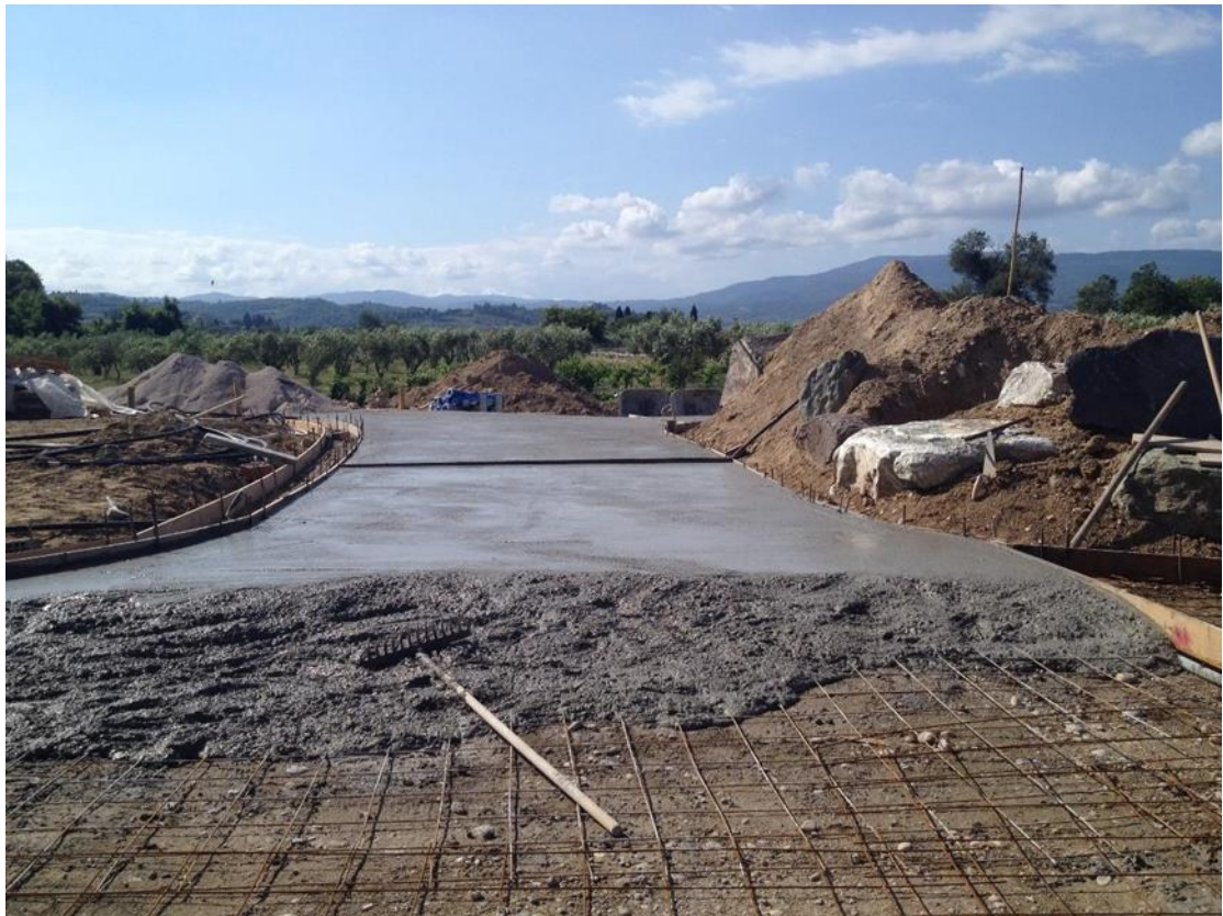
«Θαμμένο Κτίσμα», υπαίθρια διαμόρφωση, Ιστιαία, Εύβοια, 2014-16 “Buried Building”, outdoor intervention, Istiaia, Euboea, 2014-16
